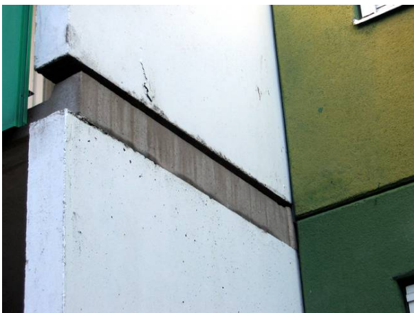
Figur 1. Här är en bild av utstickande skärmväggar på balkonger som utgör en tydlig köldbrygga.
