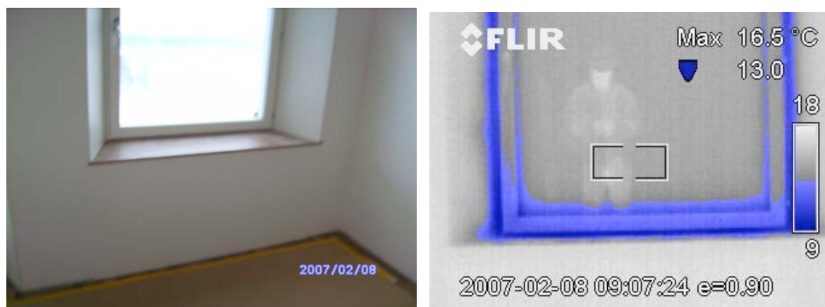
Figur 1. Värmeläckage kring fönsterparti mot öster. Bild tagen med vanlig kamera samt med värmekamera. Utomhustemperatur -8^{\circ}\text{C} . Inomhustemperatur +18^{\circ}\text{C} .
