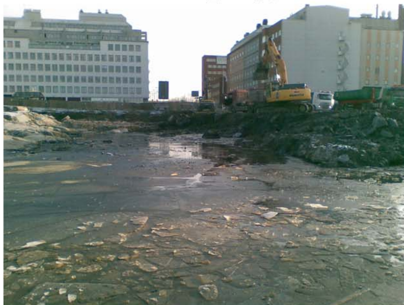
20090203 Vatten och is i schakt invid Lindhagensgatan.jpg
