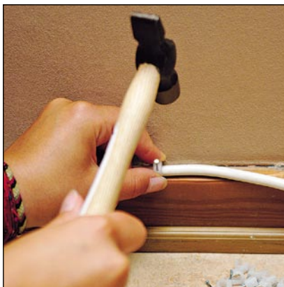
Učvršćivanje kablova (žica)
