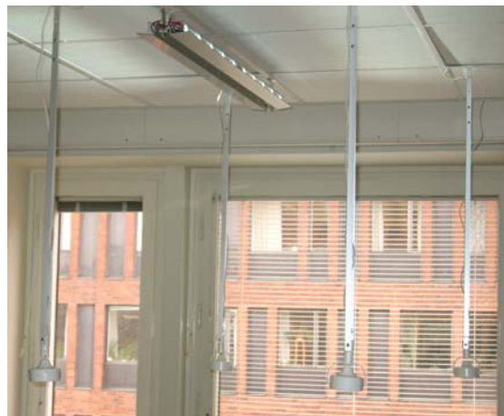
LED-belysning som kontorsbelysning på Energicentrum
